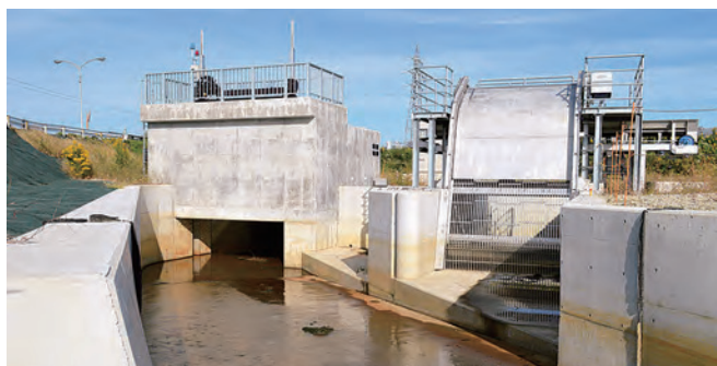
▲ 二丁堀排水機場（押切新田地内）
