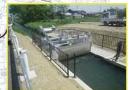
東2号幹線用水路ゲート (自動水位調整)
