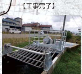
東2号幹線水路 除塵施設
