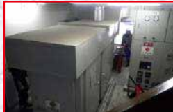
電気設備（赤川頭首工管理棟）
