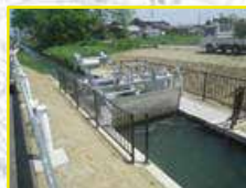
東2号幹線水路ゲート（自動水位調整）
