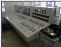
制御設備（赤川頭首工管理棟）
